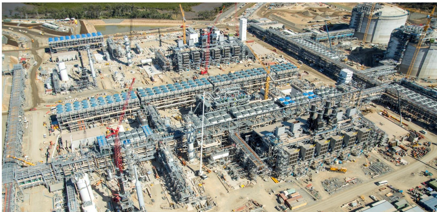
LNG trains, Curtis Island, July 2014.
