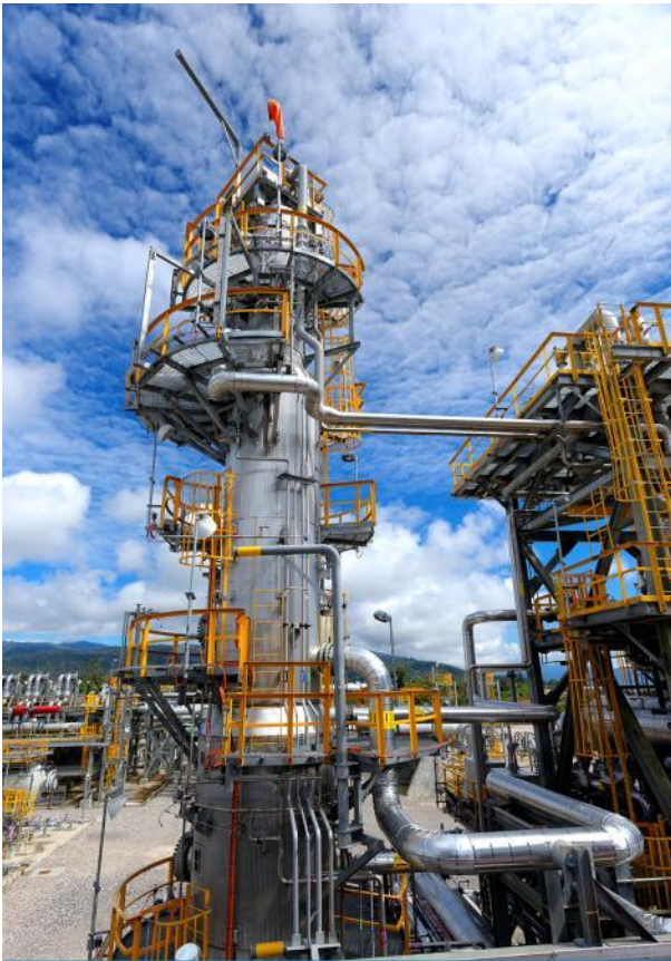
Hides Gas Conditioning Plant, PNG LNG
